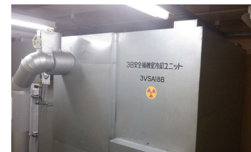
【3B安全補機室冷却ユニット】
