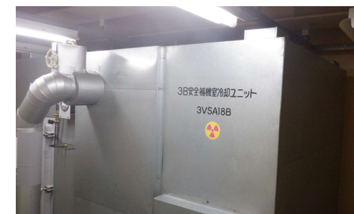
【3B安全補機室冷却ユニット】
