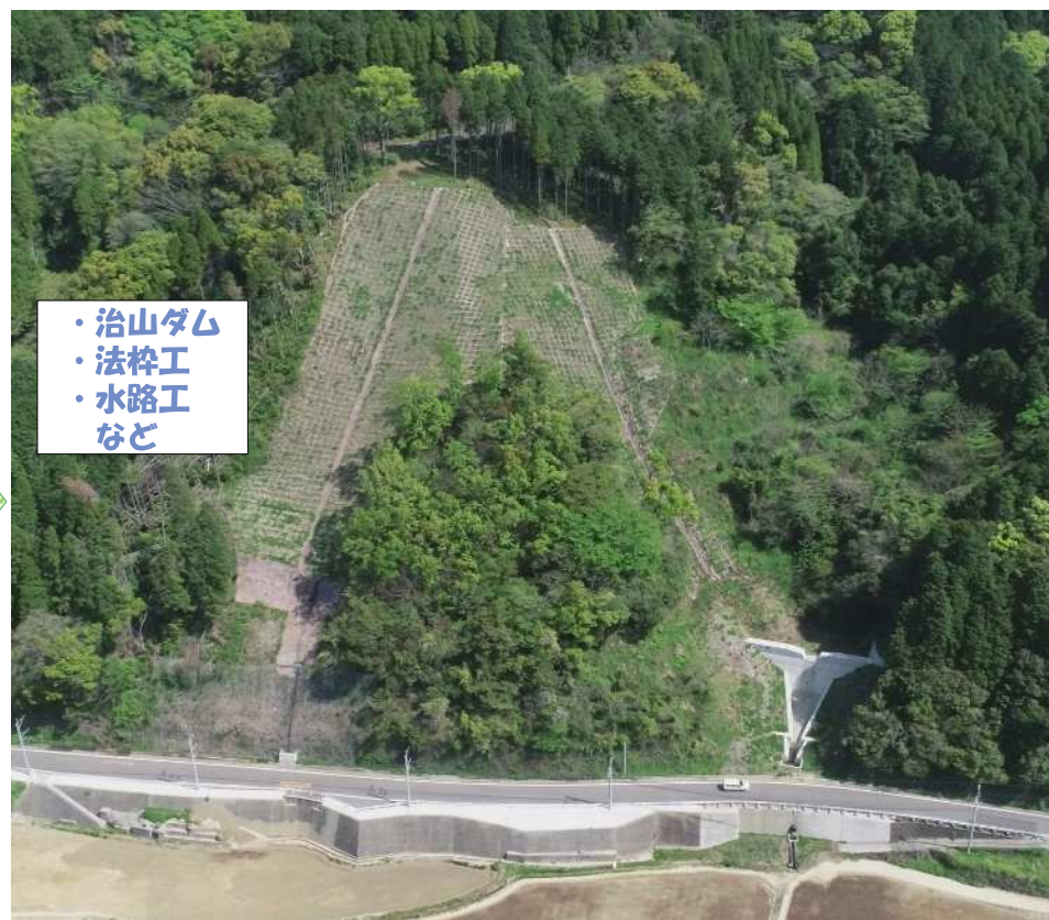
緊急総合治山事業等により工事完了（溪間工事＋山腹工事）
