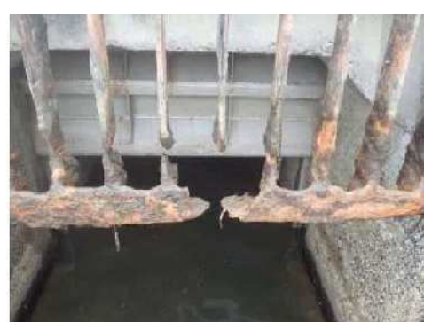
スクリーン腐食及び破断(樋門)
