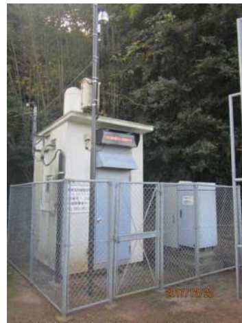
モニタリングポスト【石室局：唐津市】 空間線量率、気象データを測定
