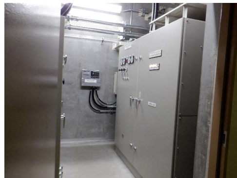
3号機充電器盤(完成)
