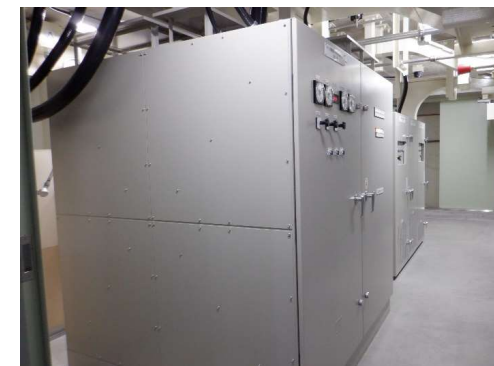
4号機充電器盤
