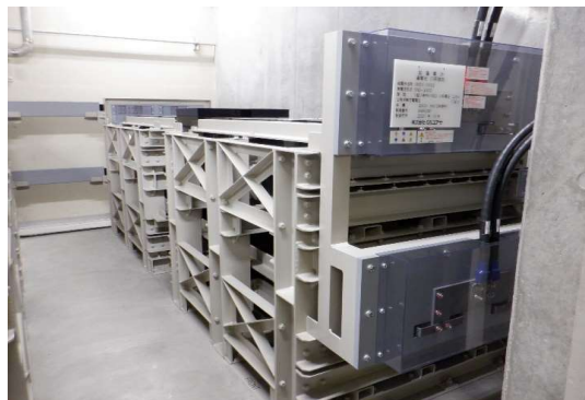
3号機蓄電池(完成)
