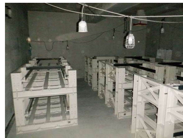
蓄電池設置場所(4号機)
