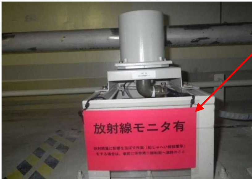
【モニタを設置している架台】
