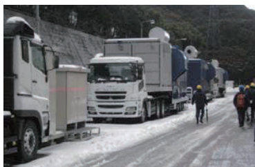
高台への電源車の配備(可搬型交流電源)
