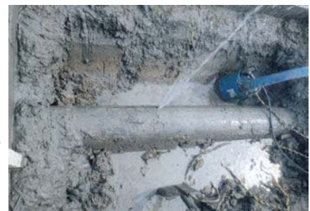
用水路(パイプライン)からの漏水状況
