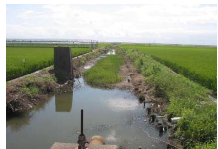
用排水路の法面崩壊、泥土堆積状況
