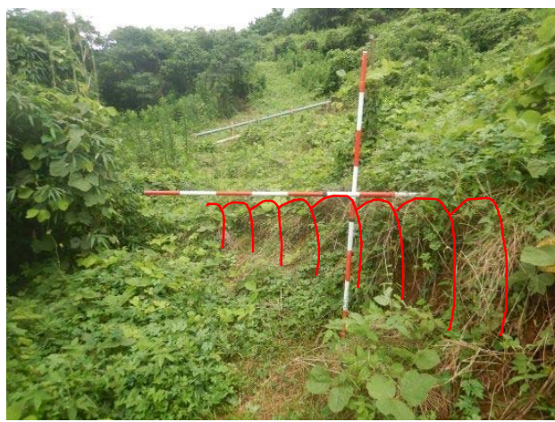
冠頭部滑落状況
