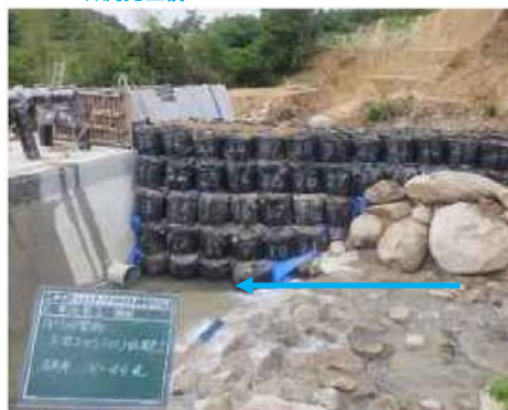
R3.7 土石流発生前
