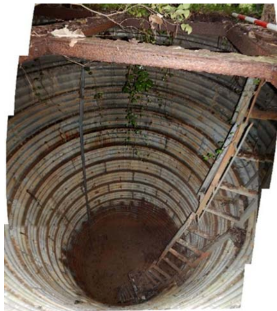
既設集水井内土砂堆積状況
