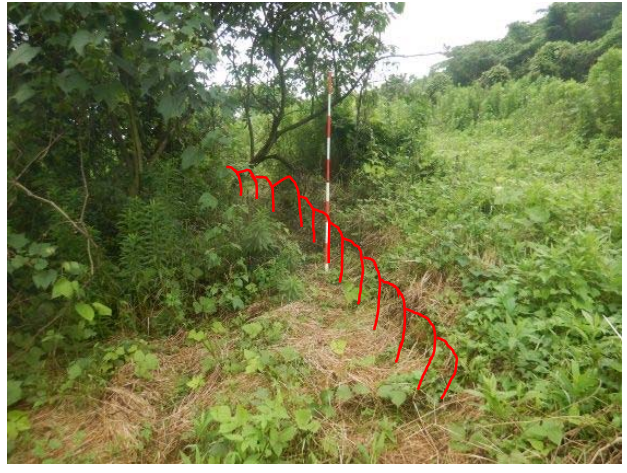
山腹斜面亀裂状況
