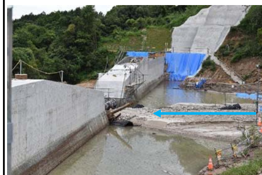
R3.8.15 土石流補足後
