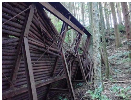
② 既設ダム腐食状況
