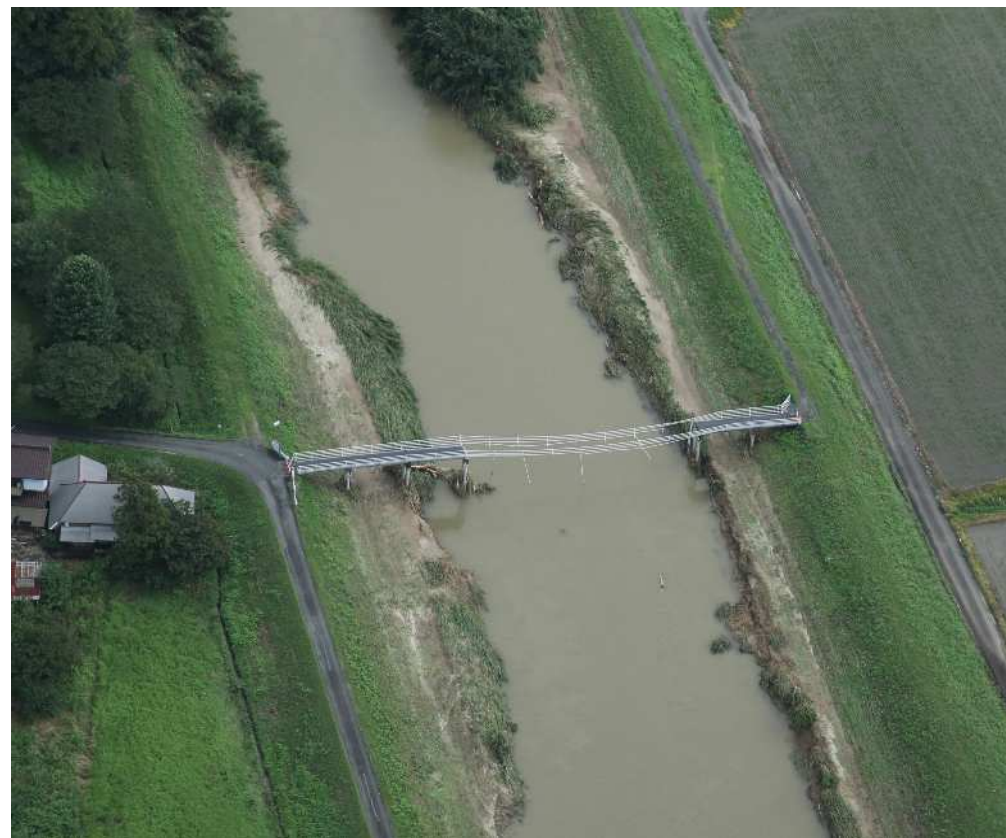
【令和5年7月】 城原川 鯉河原橋崩落（神埼市）
