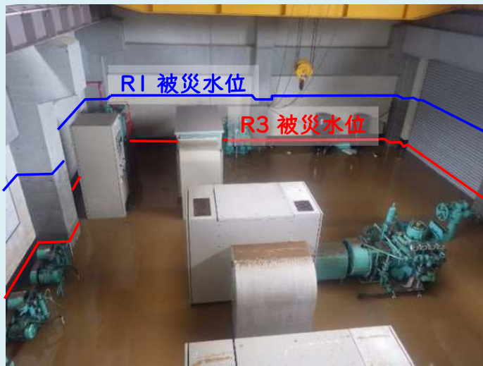
納所排水機場（多久市）
