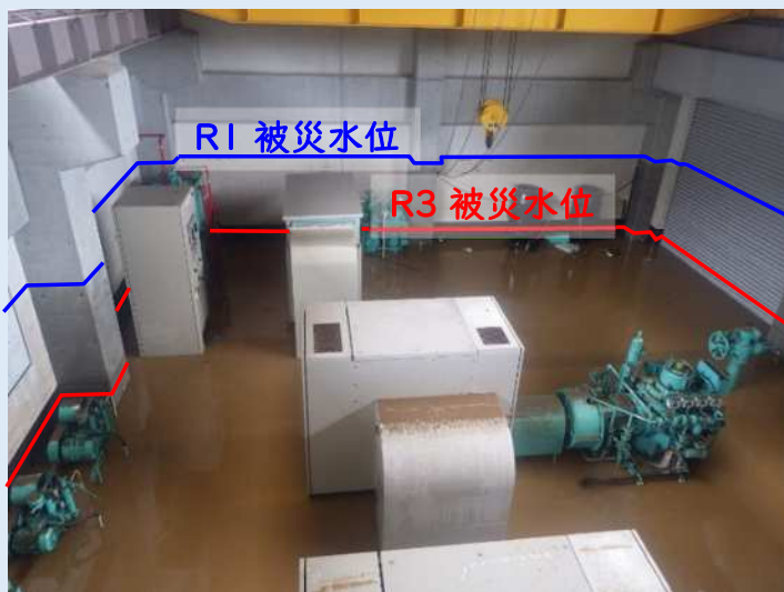
納所排水機場（多久市）
