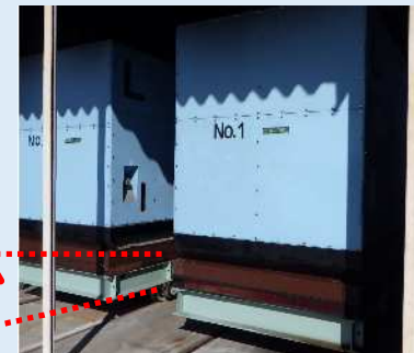
西今宿排水機場（佐賀市）
