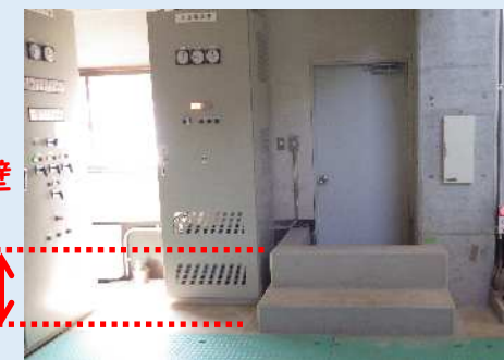
納所排水機場（多久市）
