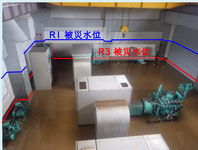
納所排水機場（多久市）
