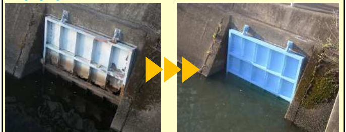
フラップゲートにおける活用事例
