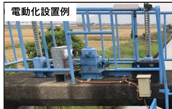
電動化設置例
