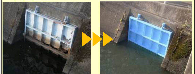
フラップゲートにおける活用事例
