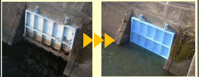
フラップゲートにおける活用事例
