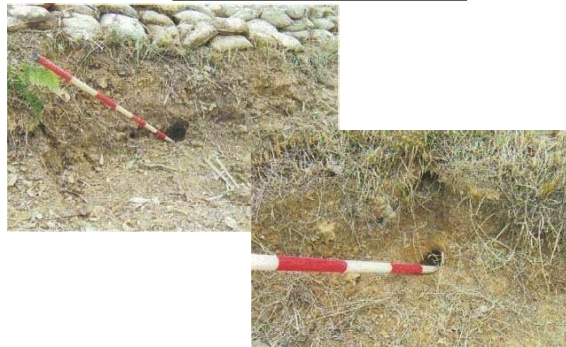
堤体のパイピング状況
