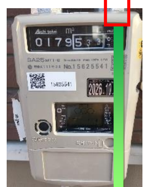
ガスメーター (有効期限 7, 10 年)
