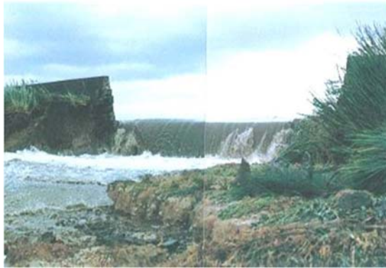
▲ 決壊した堤防
