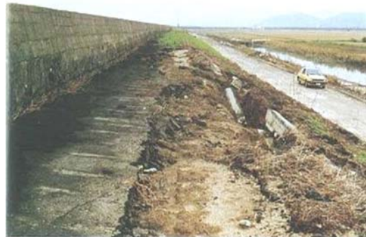
▲ 越波により流出した堤防盛土
