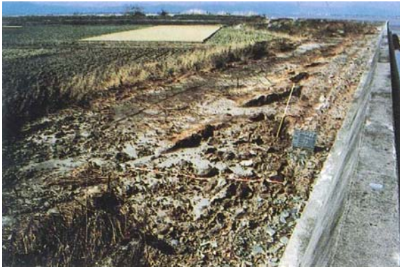
▲ 越波により流出した堤防盛土
