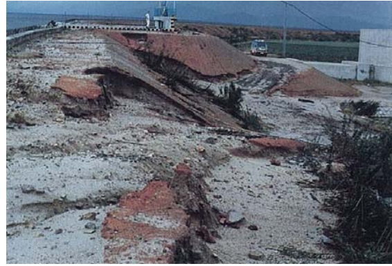
▲ 堤防盛土の流出
