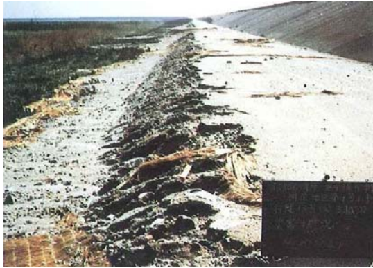
▲ 堤防盛土の流出
