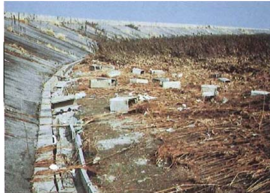
▲ 越波により破損した排水溝
