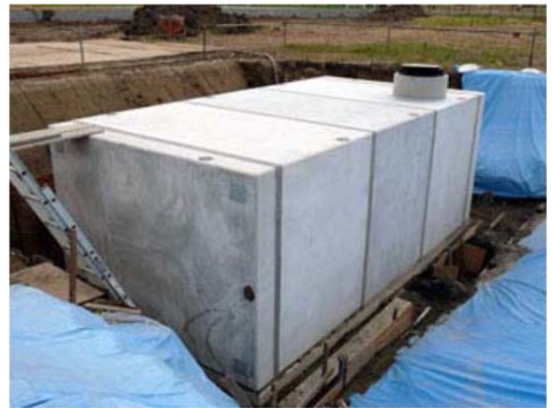
(他県事例) 耐震性貯水槽
