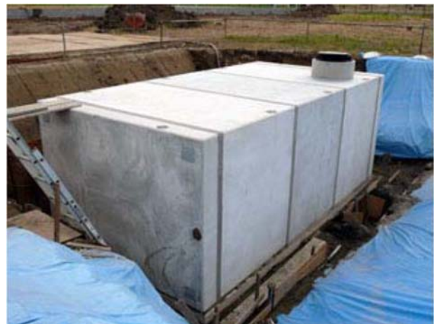
（他県事例）耐震性貯水槽
