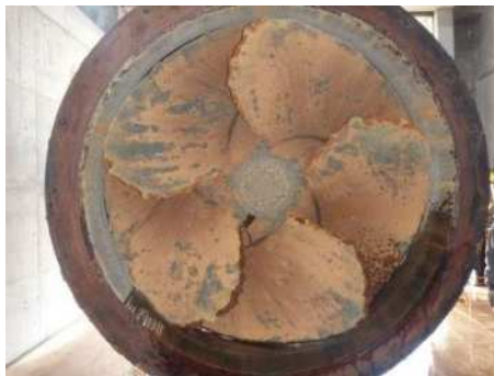
インペラ腐食状況（ポンプ内）
