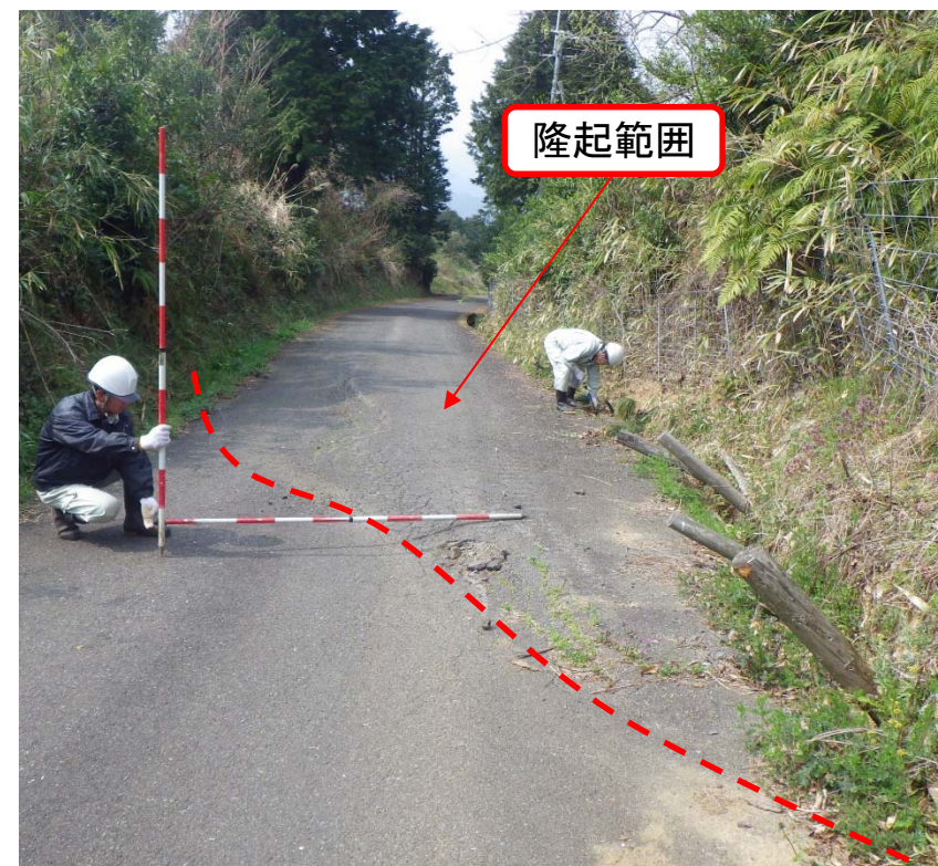
隆起により市道の亀裂・段差発生
