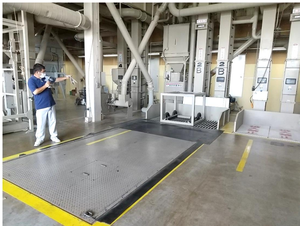
杵島東部CEでの米投入口の対応説明（危険防止のラック）
