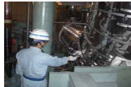
機器・配管の表面線量当量率を測定
