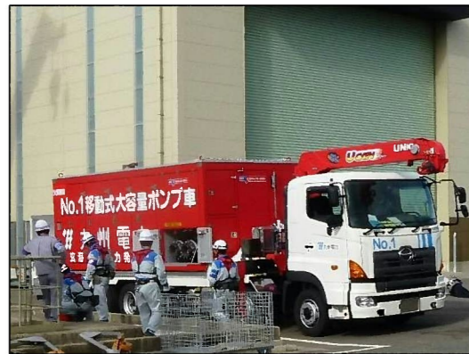
◇移動式大容量ポンプ車の設置
