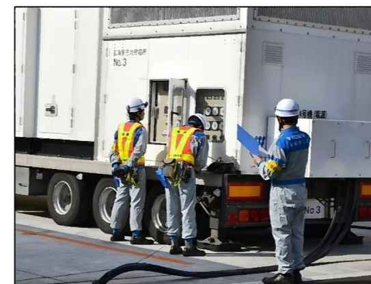
◇大容量空冷式発電機の起動
