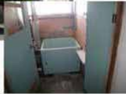
↑ 狭く、老朽化が著しい浴室の状況
