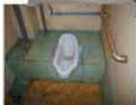
↑ バリアフリー化されていない和式便所
