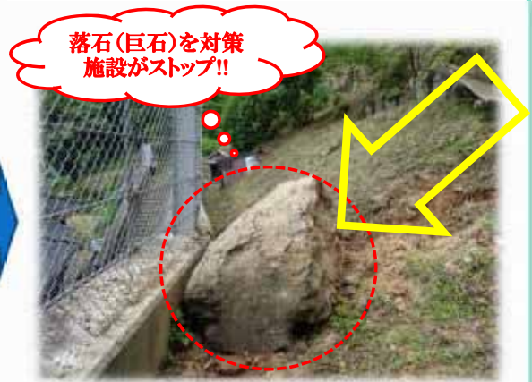
落石発生後（近景）
