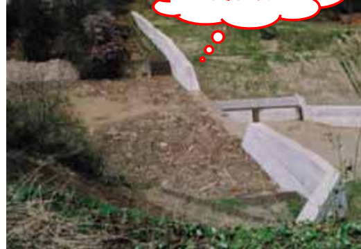
土石流発生後
