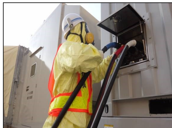
◇中容量発電機車の電源ケーブル接続 (汚染防護具着用)
