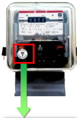
電気メーター (有効期限 10年)
