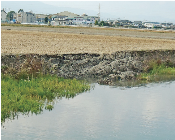
法面が崩落し、洪水調整機能が低下
