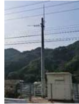
観測設備（水位局）
