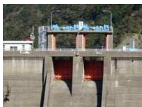
非常用洪水吐きゲート
