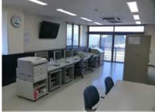
ダム管理用制御処理設備
