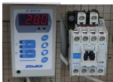
第 24 図 放熱ファンの循環ポンプを制御するサーモと ON/OFF 用リレー
