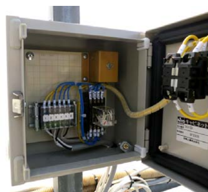
第 26 図 ハイブリットコントローラー (内部)
