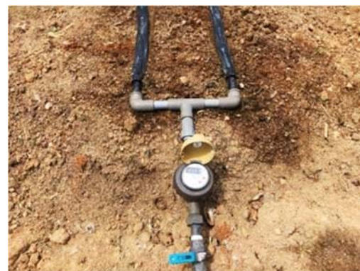
図7 灌水資材と水量計の設置
