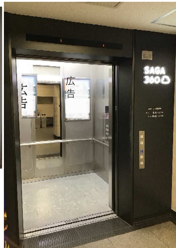
展望用エレベーター(左右2箇所)
