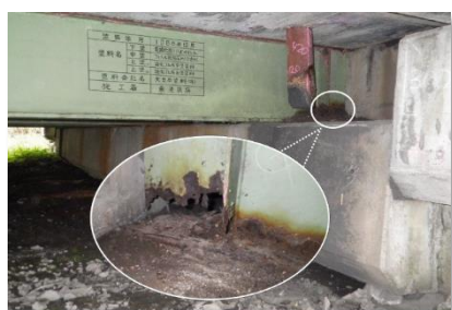
損傷内容：主桁端部・支承の腐食
