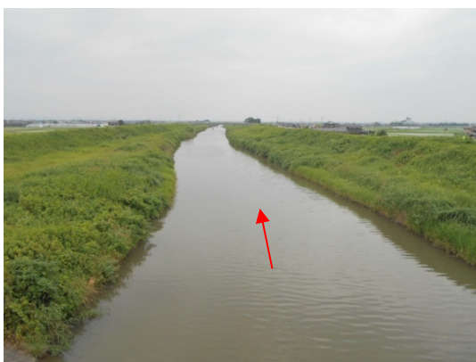
写真 2.9 田園地帯の流下状況 (田手川上流：広円橋下流)
