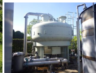
水質浄化設備
