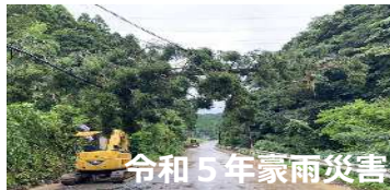
令和5年豪雨災害 倒木が電線に接触したため停電
