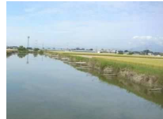
崩壊したクリーク法面
