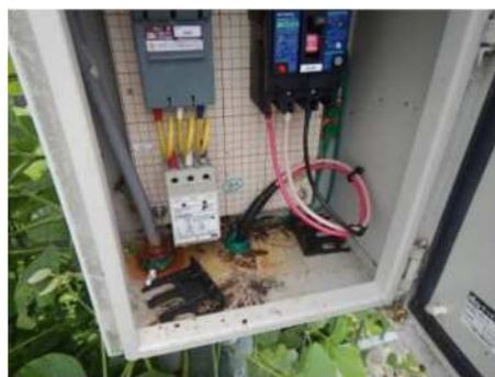
引込開閉基盤の発錆
