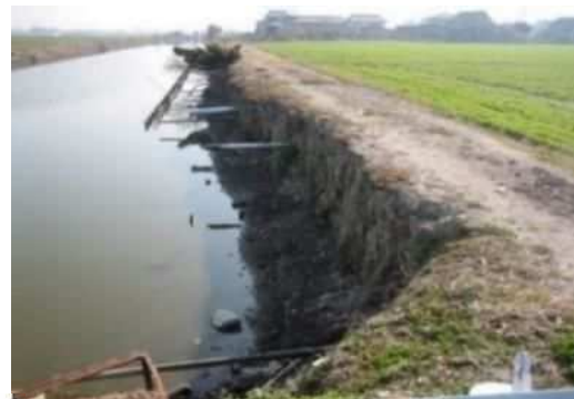
崩壊したクリーク法面
