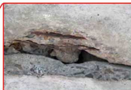
コンクリート剥落
