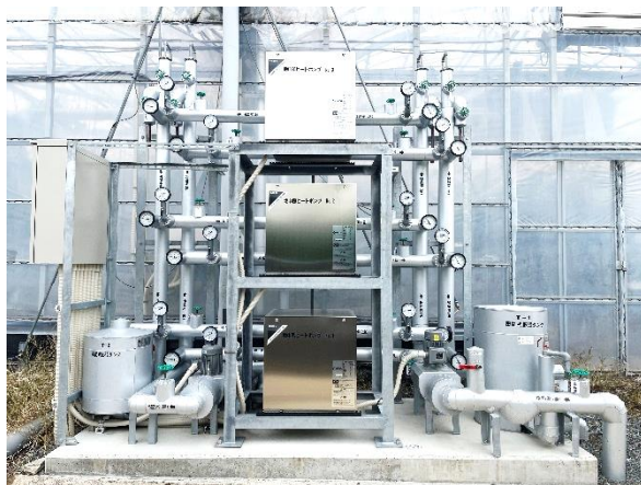
【地中熱ヒートポンプ】
