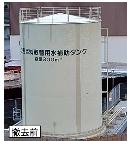
燃料取替用水補助タンク
