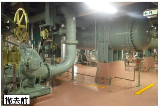
原子炉補機冷却水冷却器・ポンプ
