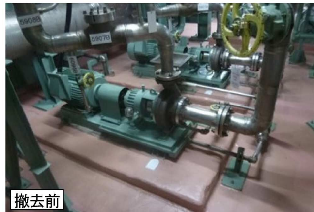
一次系補給水ポンプ
