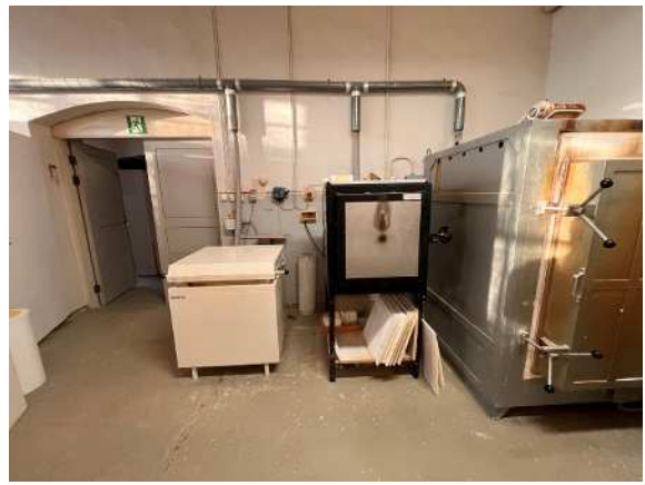
窯などの設備
