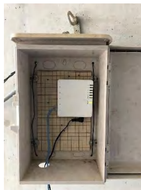
【坑内にWi-Fiルーターの設置(@100m)】
