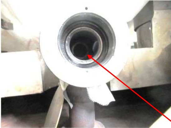
（１１）手入れ後の弁座（既設品）と弁体（定検取替品）との当たり ・弁座
