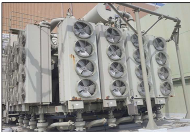
主／所内変圧器
